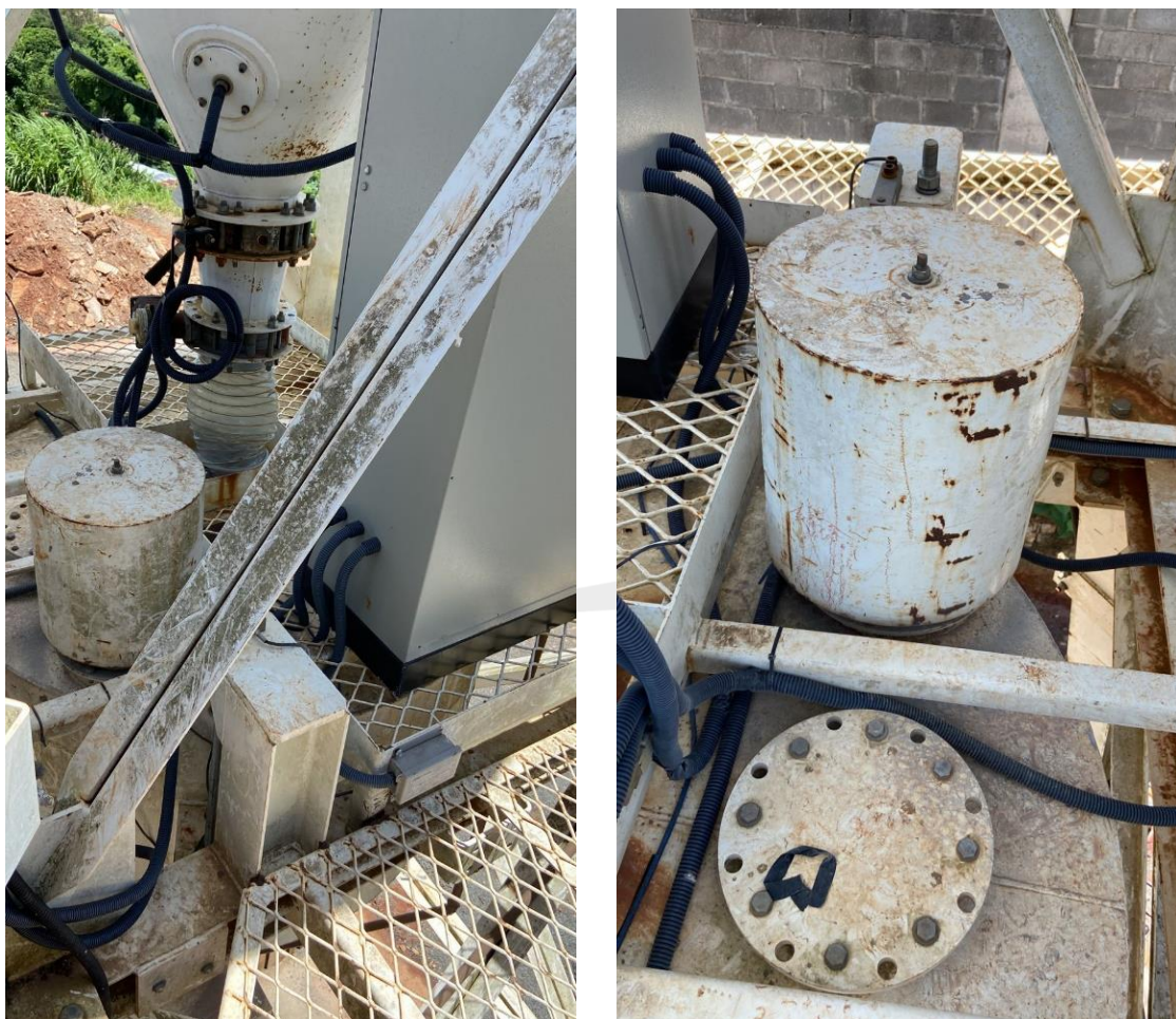
Figura 20: Imagens do filtro da balança de cimento.
