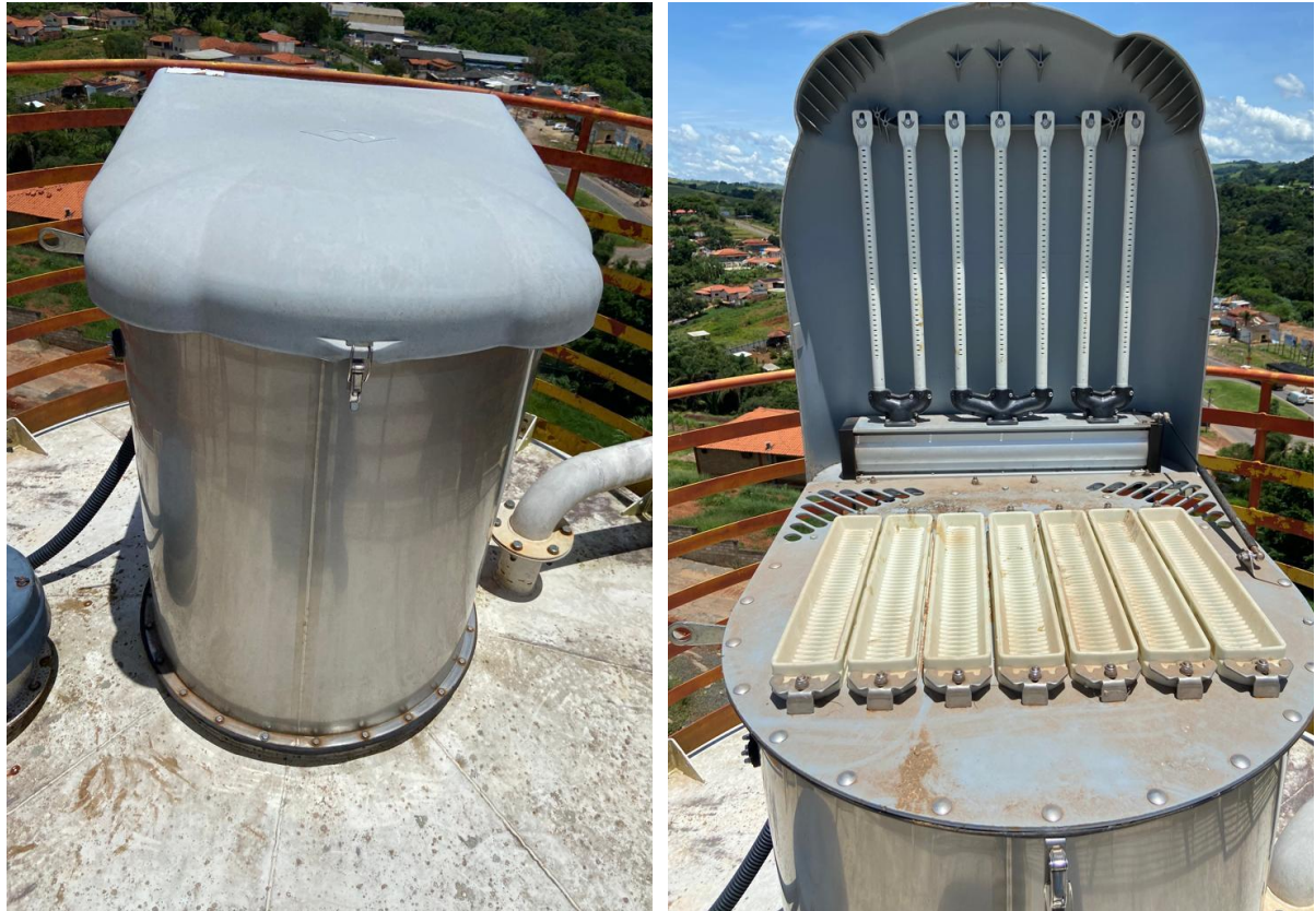
Figura 21: Imagens do filtro do silo de cimento.
