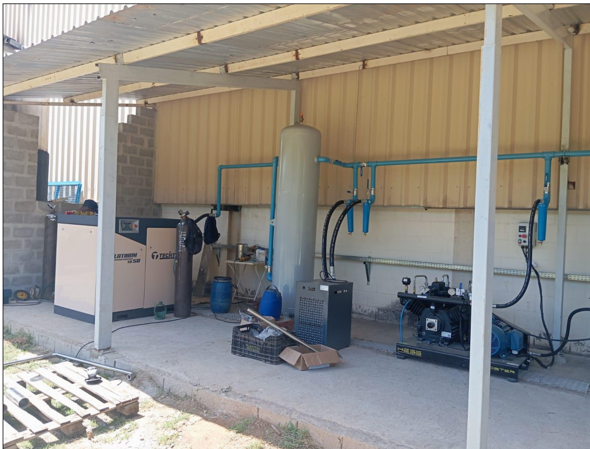
Foto 04: Sala de máquinas do galpão industrial.
