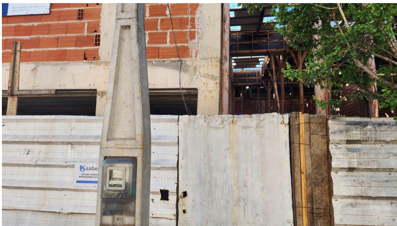
Fig 13 – Poste de entrada de energia (CPFL) e placa de leitura de água (SABESP)
